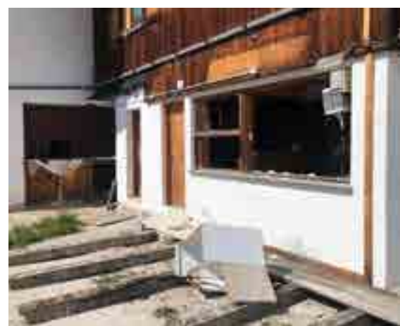
Il rifugio Col Tondo con i vetri rotti e nessuna transenna che ne perimetri la zona pericolosa per i passanti
